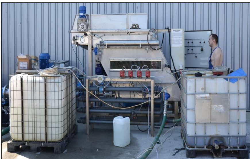
Fot. 29. Pilotażowa instalacja do oczyszczania zużytej wody technologicznej w porcie (fot. MIR-PIB)
